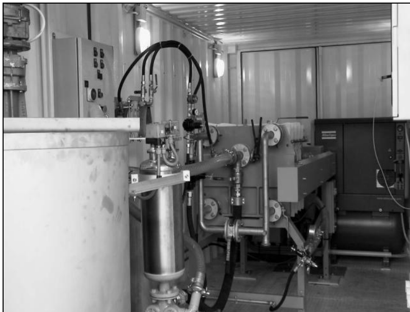
Rys. 2. Prasa filtracyjna ME 630 zabudowana w kontenerze (źródło: opracowanie własne) Fig. 2. Filter press model ME 630 installed in a container (source: own materials)
