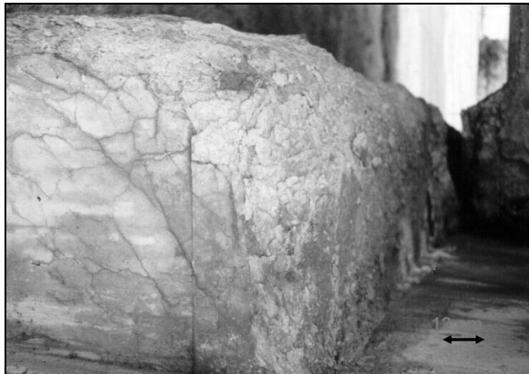
Rys. 6. Wiadukt k. Kielce. Destrukcja elementów betonowych wywołana reaktywnością alkaliczną. Odpryskiwanie i łuszczenie się betonu. Widoczne wycieki żelowe oraz rdzawe nacieki pochodzące od korodującego odkrytego zbrojenia (Góralczyk, 2000)
