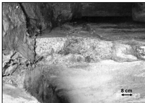
Rys. 7. Wiadukt k. Kielc. Destrukcja elementów betonowych wywołana reaktywnością alkaliczną. Odpryskiwanie i łuszczenie się betonu. Widoczne wycieki żelowe oraz rdzawe nacieki pochodzące od korodującego odkrytego zbrojenia (Góralczyk, 2000)
