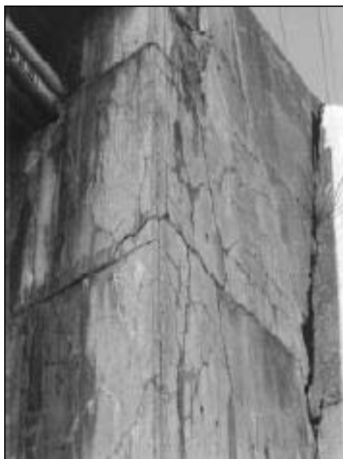
Rys. 4. Ściana oporowa. Pękanie i uszkodzenia powierzchni betonu na elementach betonowych konstrukcji wystawionych przez dłuższy czas na działanie wilgoci; niektóre pęknięcia wypełnione są żelem (RILEM TC 219 ACS, 2001)
