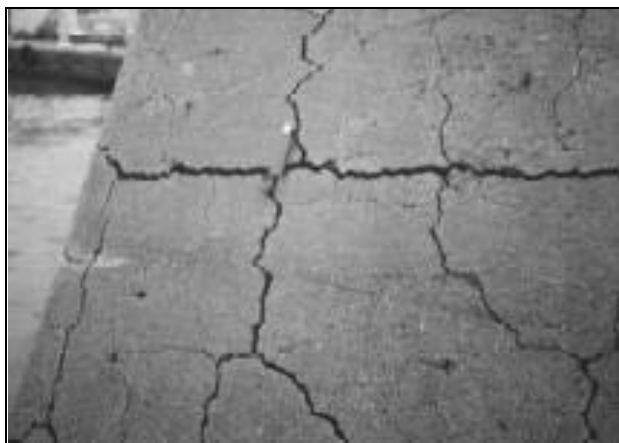
Rys. 3. Fragment ściany. Spękania powierzchni konstrukcji betonowych spowodowanych reakcjami alkalicznymi, niektóre szczeliny wypełnione są żelem (RILEM TC 219 ACS, 2001)
