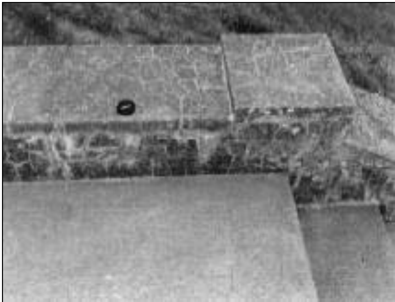
Rys. 2. Chodnik betonowy. Spękania powierzchni konstrukcji betonowych spowodowanych reakcjami alkalicznymi, niektóre szczeliny wypełnione są żelem (RILEM TC 219 ACS, 2001)
