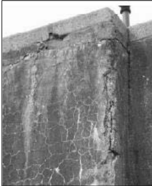
Rys. 5. Fragment przyczółka śluzy. Ściana oporowa. Pękanie i uszkodzenia powierzchni betonu na elementach betonowych konstrukcji wystawionych przez dłuższy czas na działanie wilgoci; niektóre pęknięcia wypełnione są żelem (RILEM TC 219 ACS, 2001)
